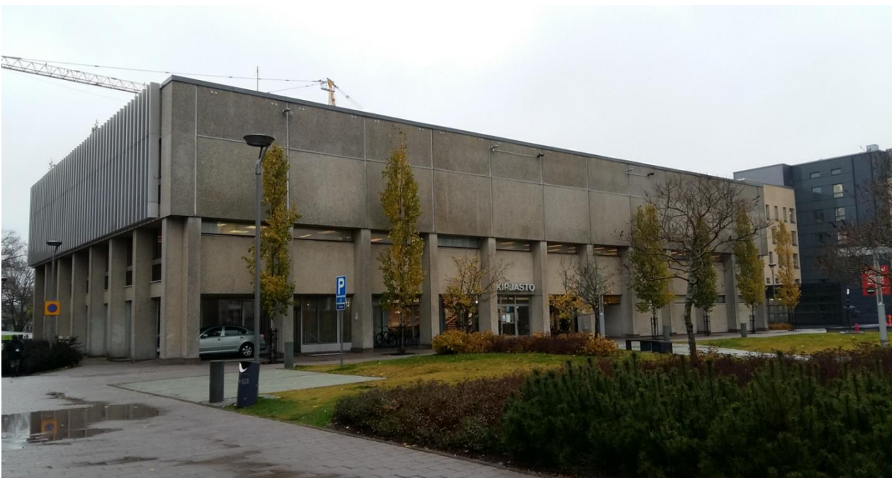
Kuva 4: Pääkirjaston eteläjulkisivun viereiset pylväshaavat ja puiston pensas- ja nurmi-alueita (Lappeenrannan kaupunkisuunnittelu).
